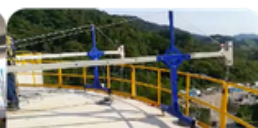
Pescante móvil para mantenimiento de tanques
